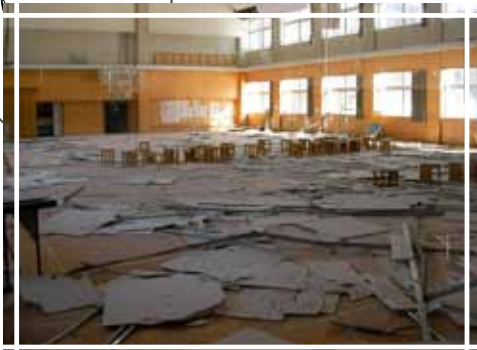
津南町上郷小学校 体育館天井パネル落下の様子
